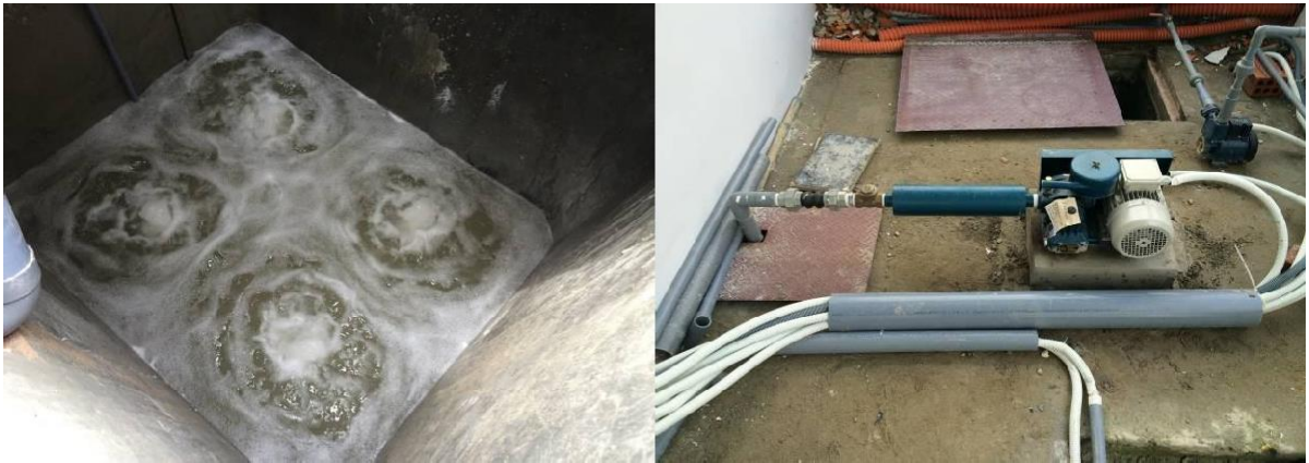
Hình 3.5. Bể Aerotank và máy thổi khí
