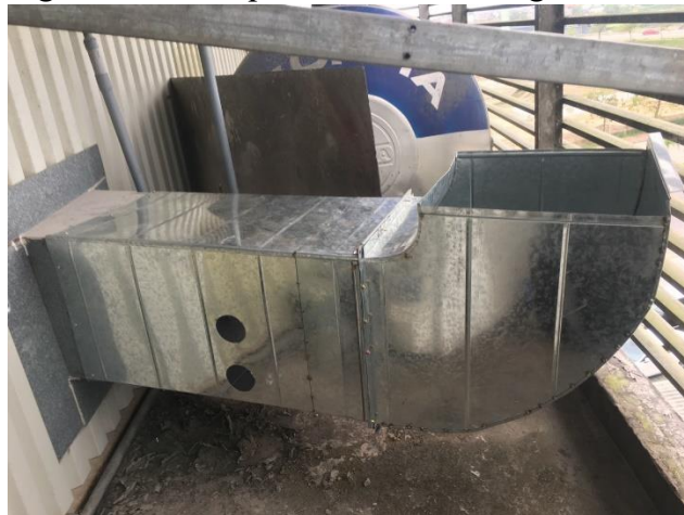
Hình 3.12. Ống khói thải của hệ thống xử lý bụi, khí thải tại công đoạn sơn
