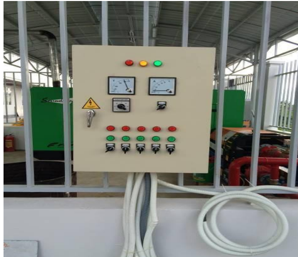
Hình 3.7. Tủ điện điều khiển
